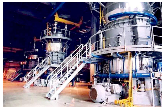
磨煤机称重系统
